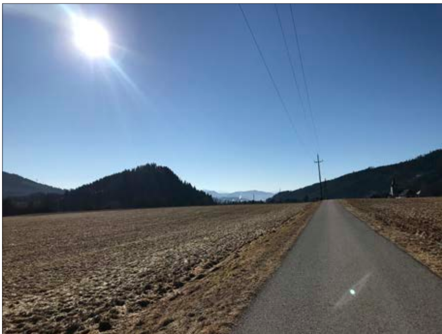
20kV- Leitung Micheldorf (Quelle: eigene Aufnahme)
