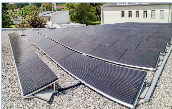
PV- Anlage VS Krumpendorf (Quelle: wir-energie.at)
